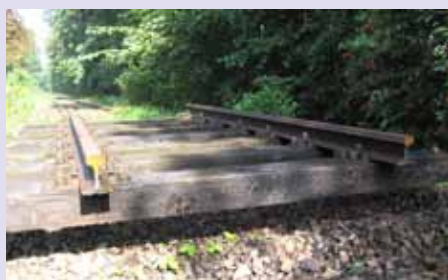
Das Mitte 2011 von DB Netz heraus getrennte, etwa 4 m lange Gleisstück bei km 4,3 zwischen Halle-Nietleben und Halle-Dörlau | Foto: HHE e. V.
